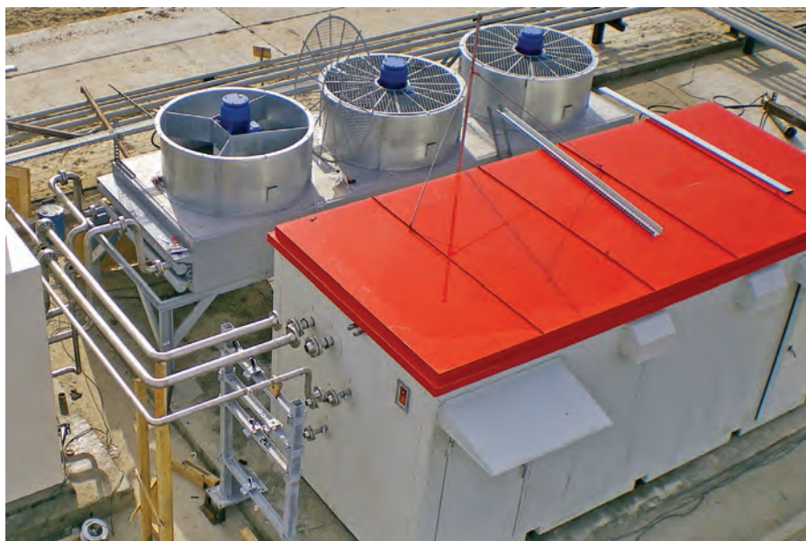
Фото 7. Адсорбционный осушитель газа на ЦПС Западно-Могутлорского месторождения
