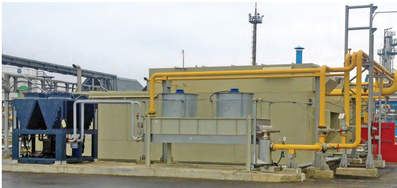
Фото 8. Рефрижераторная установка газоохлаждения в составе системы подготовки ПНГ
