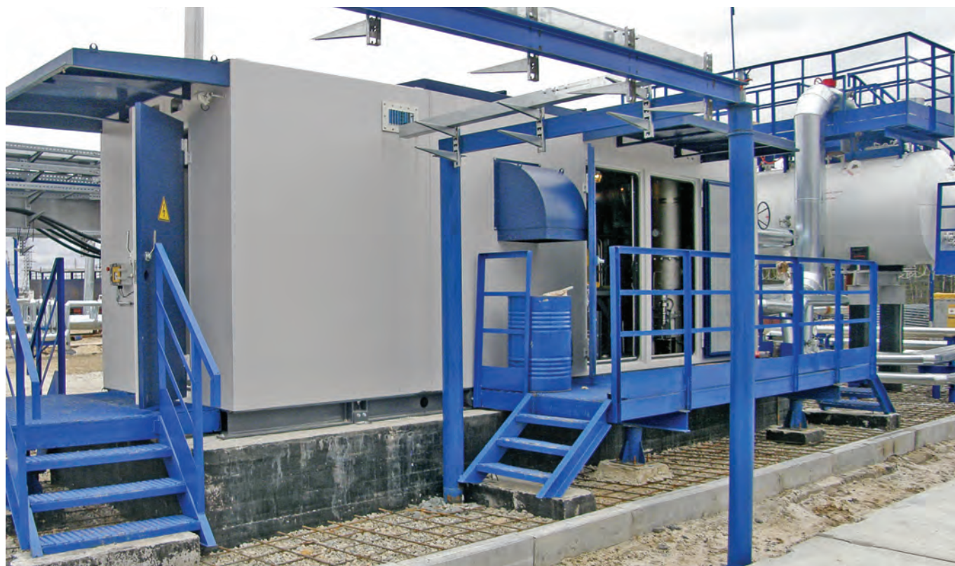
Фото 4. Вакуумная КС «ЭНЕРГАЗ» на Вынгапуровском промысле (ОАО «Газпромнефть-ННГ»)
