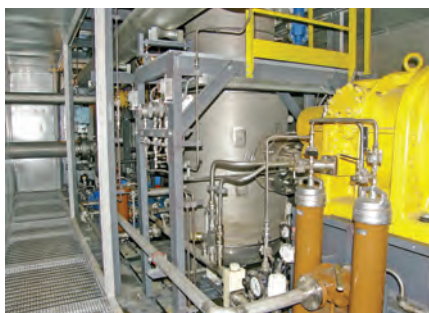
Фото 5. Компрессорная установка в арктическом исполнении
