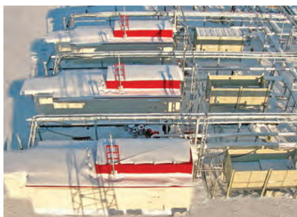
Фото 3. КУ низкого давления в составе компрессорной станции Мурьяунского месторождения
