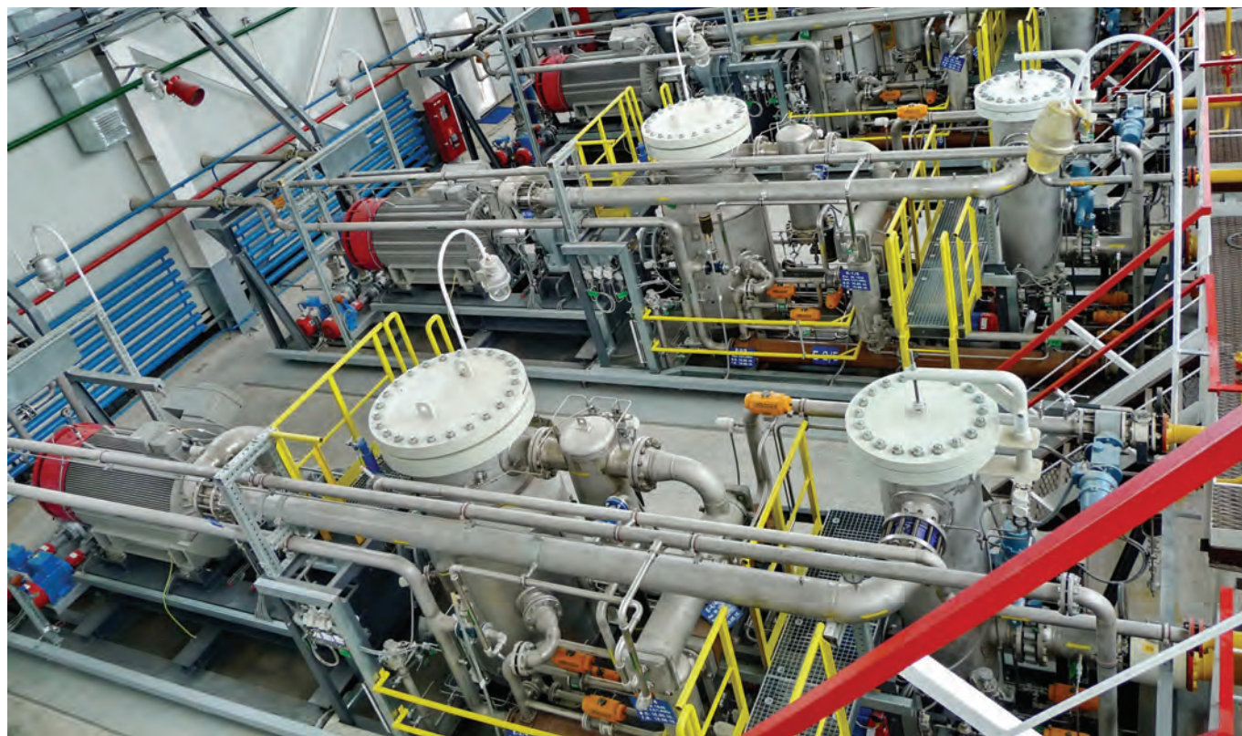
Фото 6. УПТГ на открытой раме для ГТЭС Талаканского месторождения
