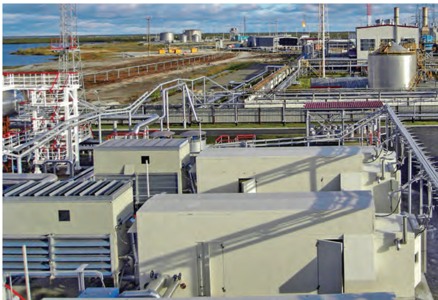
Фото 1. Компрессорные установки Биттемского месторождения (ОАО «Сургутнефтегаз») для транспортировки ПНГ
