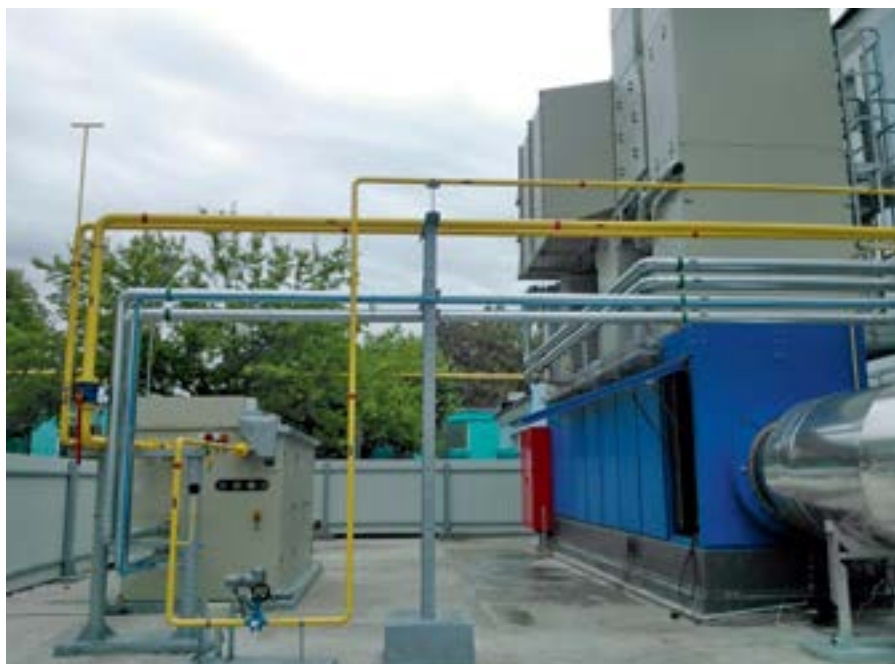
Фото 4. Малая ГКУ для ГТУ Turbomach TBM-C40 мощностью 3,5 МВт (энергоцентр Минского КСИ)
