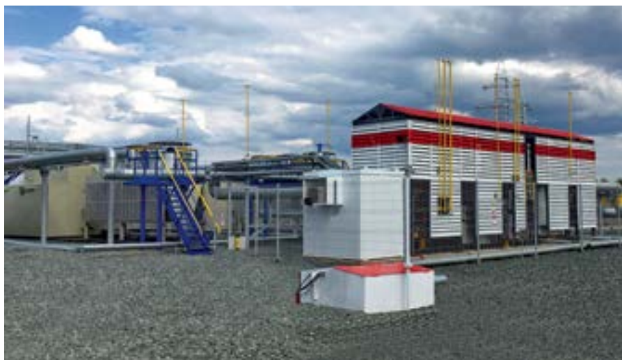
Фото 1. Система газоподготовки и газоснабжения «ЭНЕРГАЗ» для энергоцентра ООО «ЛУКОЙЛ-Коми»
