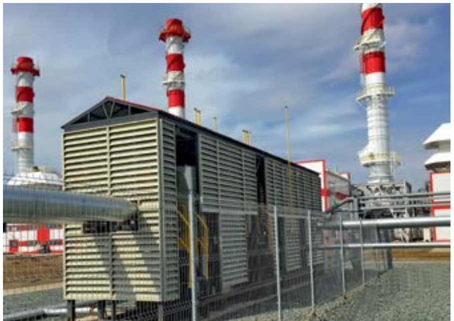
Фото 3. Блок подготовки попутного газа на Усинском месторождении
