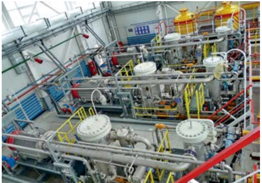
Фото 2. Компрессорные установки ангарного (цехового) типа для ГТЭС Талаканского месторождения
