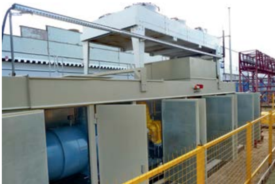
Фото 9. Установка газоподготовки «ЭНЕРГАЗ» для испытательного стенда АО «ОДК-Газовые турбины»
